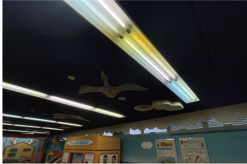
一部LED化が進んでいない展示室
