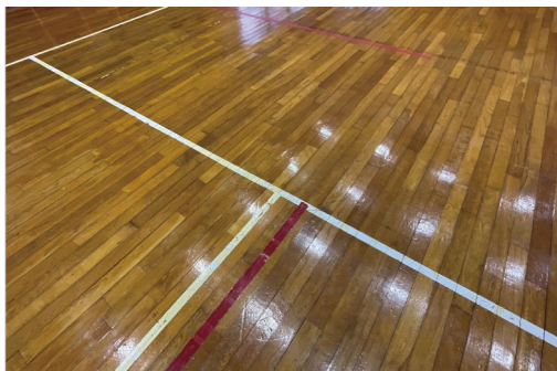
経年劣化が目立つ遊戯室の床
