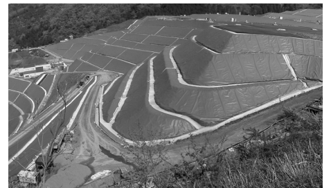
最終処分場(櫻曲)の抜本対策工事(雨水の浸水を防ぐための遮水シートによるキャッピング)
