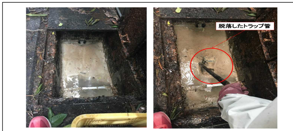
図 除害施設の管理不足例
