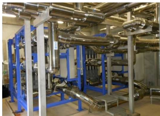
図 3-2 疋田浄水場（膜ろ過 10 施設）
