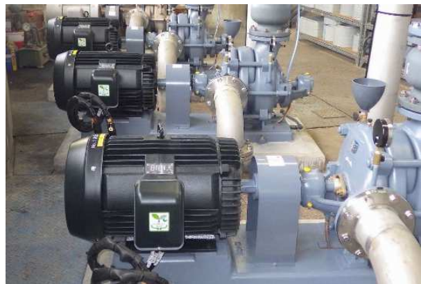
図 3-25 省エネルギー型機器 (トッランナーモータ (昭和浄水場))
