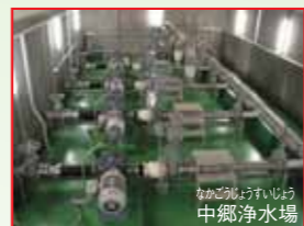
中郷浄水場 送水ポンプ 配水池へ水を送ります。
