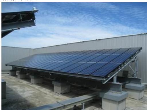
太陽光発電設備（防災センター屋上）
