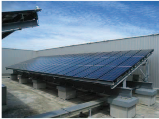
太陽光発電設備（防災センター屋上）
