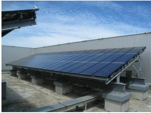
太陽光発電設備（防災センター屋上）
