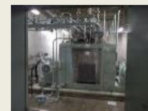
油タンク（高圧油ユニット）
