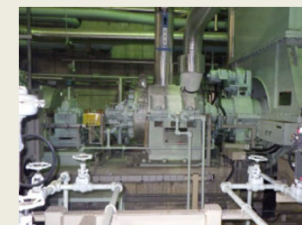
主給水ポンプ
