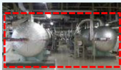
高圧第1、2給水加熱器（解体撤去前）
