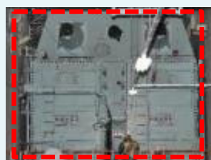
復水器（解体撤去前）
