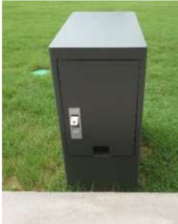
電源、上水道外観
