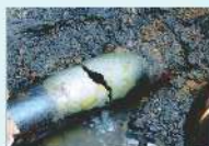
地中で断裂した水道管
