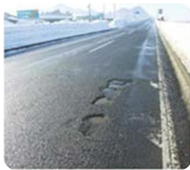
路面の穴ぼこ・ 段差
