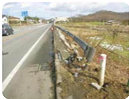
ガードレール・ 標識等の損傷
