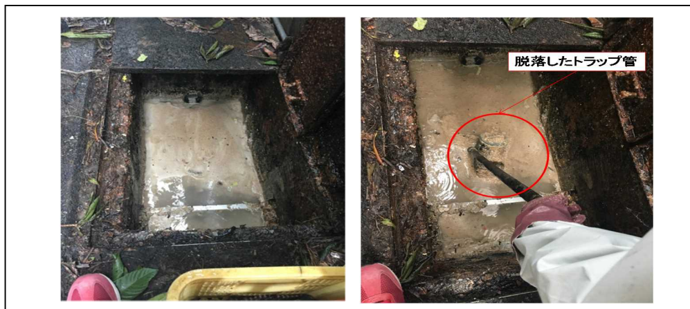
図 除害施設の管理不足例
