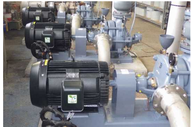
図 3-23 省エネルギー型機器 (トップランナーモータ (昭和浄水場))
