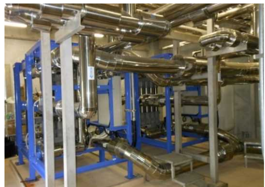
図 3-2 疋田浄水場（膜ろ過 9) 施設）
