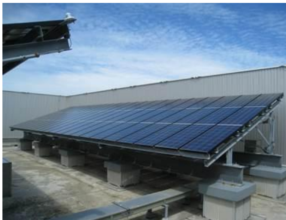
太陽光発電設備(防災センター屋上)
