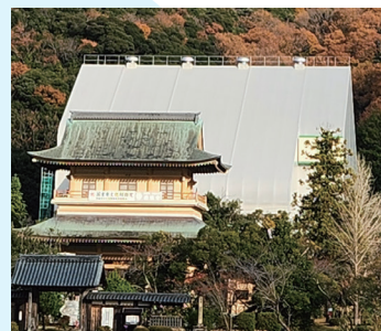
完成した巨大な覆屋は 敦賀駅新幹線ホームからも見えます
