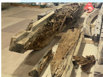
破損している部材
