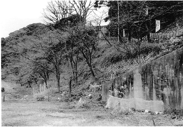
①金崎宮登り口付近、斜面部（土砂災害特別警戒区域）状況 ※一部斜面部に土砂崩れの状況が見られます。
